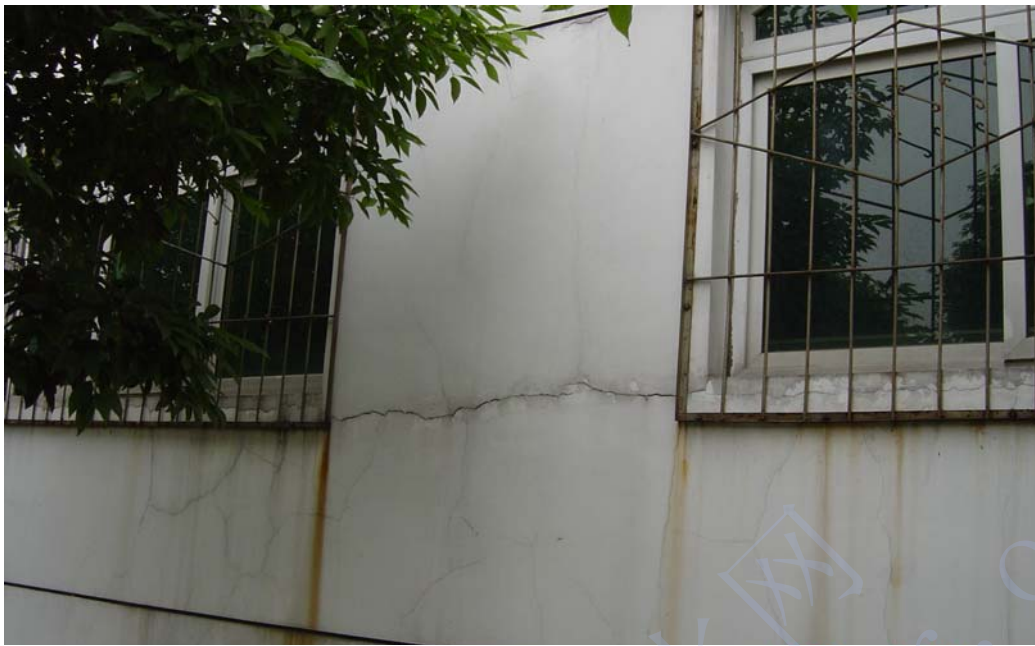
图4-1 某加药间的墙体破坏
